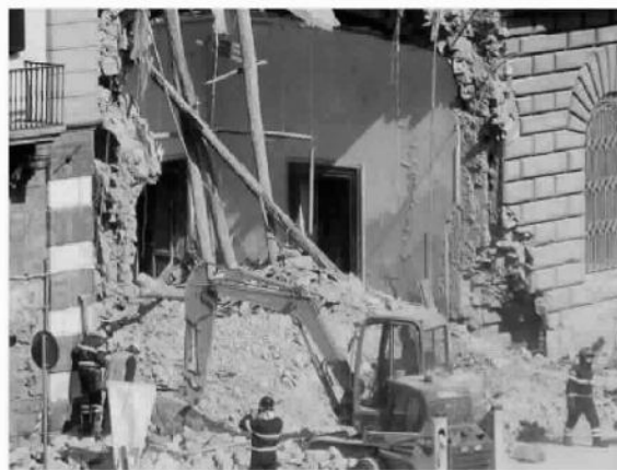
In alto, quel che resta dell'area museale di Città della Scienza. Sopra, il palazzo crollato alla Riviera di Chiaia
